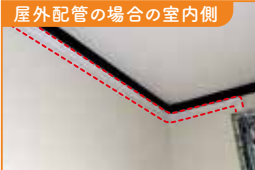
屋外配管の場合の室内側
