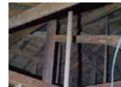
全体の劣化が分かる写真
