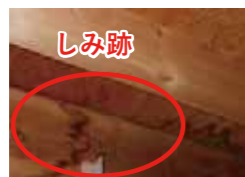
雨漏れ・しみ跡が分かる写真
