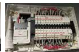
分電盤の詳細が分かる写真
