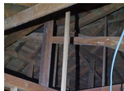
全体の劣化が分かる写真
