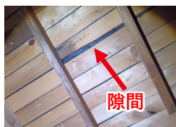
小幅板の隙間が分かる写真
