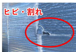
屋根材のヒビ、割れが分かる写真
