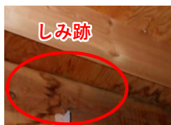
雨漏れ・しみ跡が分かる写真
