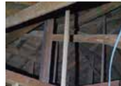
全体の劣化が分かる写真
