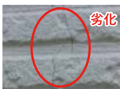
外壁の劣化が分かる写真
