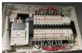
分電盤の詳細が分かる写真
