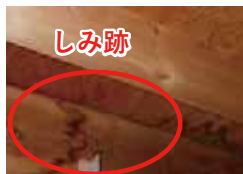
雨漏れ・しみ跡が分かる写真
