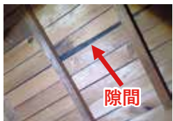
小幅板の隙間が分かる写真
