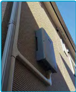
屋外配管事例
