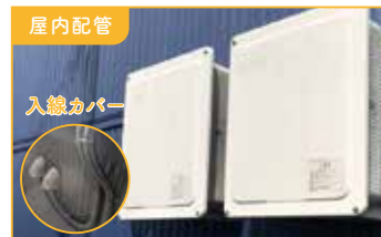
屋内配管 入線カバー パワーコンディショナへの配管・配線が 壁内を通ります。
