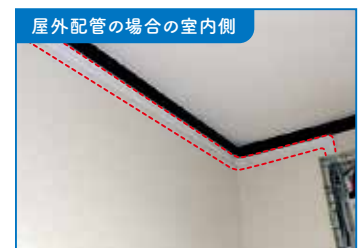
屋内側の配線が内壁材の外側を通る場合があります。(赤点線部)
